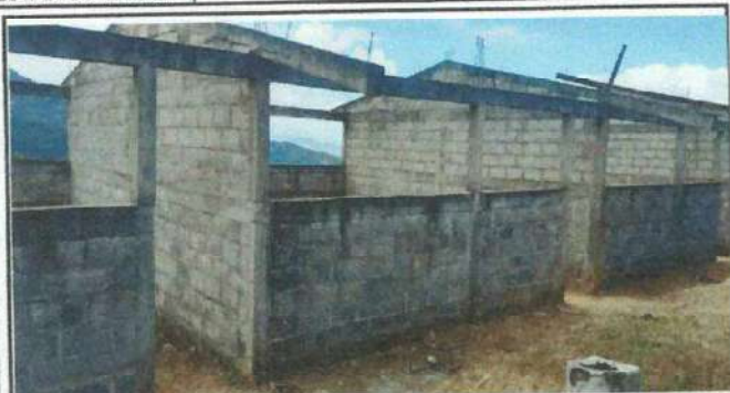
Foto 1: Se observa que el Instituto tiene varias necesidades, en la fotografía se observa la necesidad de puertas y balcones.
