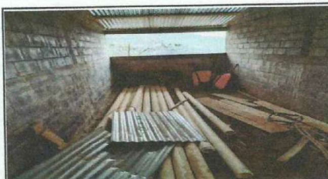
Foto 4: Se observa las condiciones en las que se encuentra la direccion, necesita repello, techo, balcones y puerta.
