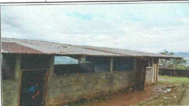
Foto 2: Se observa que el establecimiento esta forrado con laminas deterioradas.
